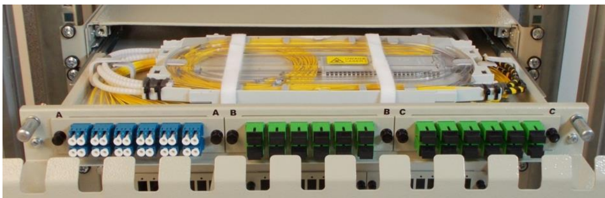
Fot.2. Widok półki z kasetą spojeń KSP24
