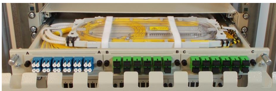
Fot.1. Widok wysuniętej półki z kasetą spojzeń KSP24
